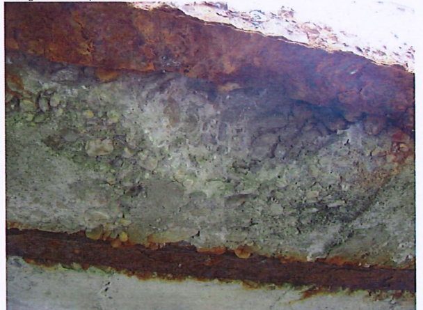
Dettagli corrosione piattaforma
