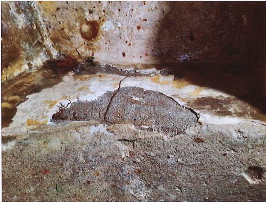
Scrostamenti e fessurazioni sulla platea di fondo
