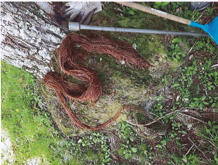
Infiltrazione di radici
