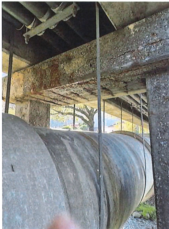
Foto 16 - Dettaglio trave di collegamento con fessure e ferri arrugginiti
