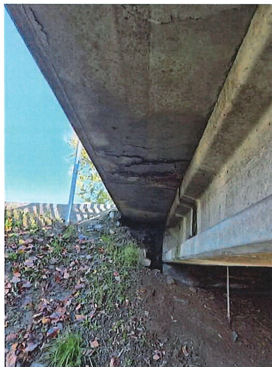
Foto 18 - Dettaglio sottovista con distacchi
