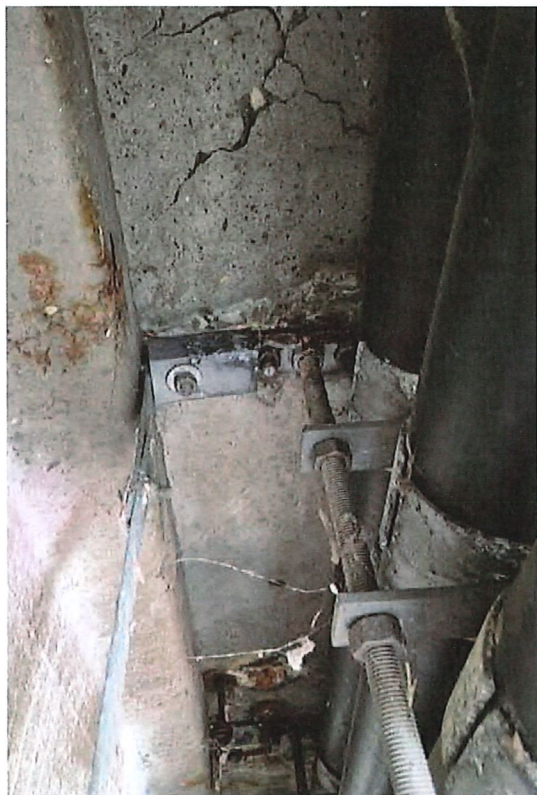
Foto 21 - Dettaglio fissaggi sospensioni con distacchi
