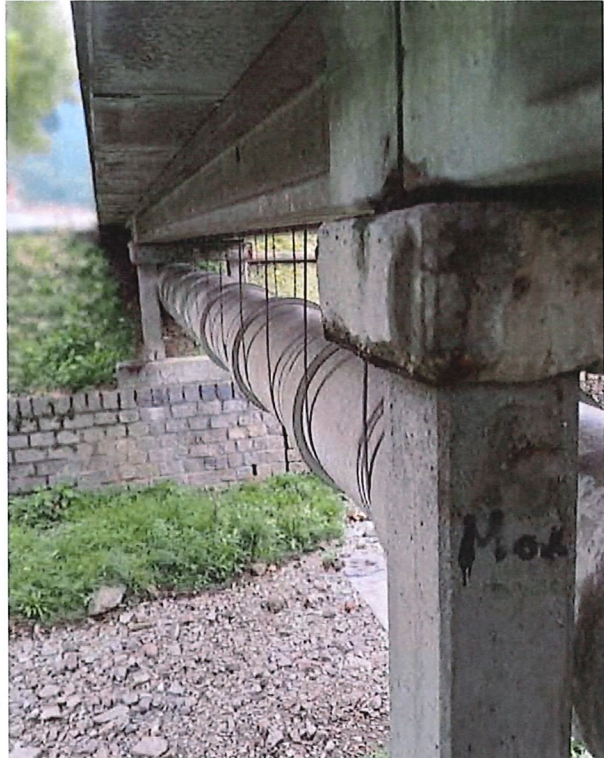
Foto 12 - Sottovista, pila lato Sud con fessure e
