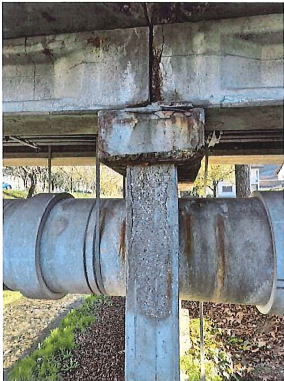
Foto 15 - Dettaglio pila lato Sud e cavo di sospensione della condotta ceduto
