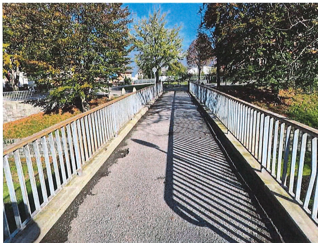
Foto 8 - Piattabanda con pavimentazione fortemente deteriorata
